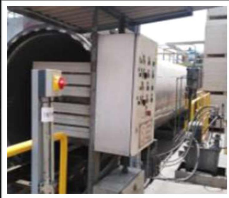
Sistema de Seguridad , LOTOTO de motores de fuerza, 120 motores
