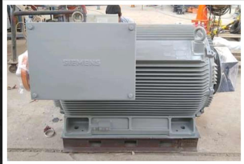
Servicio de mantenimiento correctivo de motores 1000 HP Proyecto 1mes PROTISA – Sede Cañete
